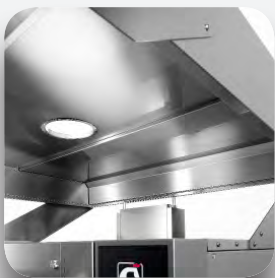
Conducto humos y campana.
